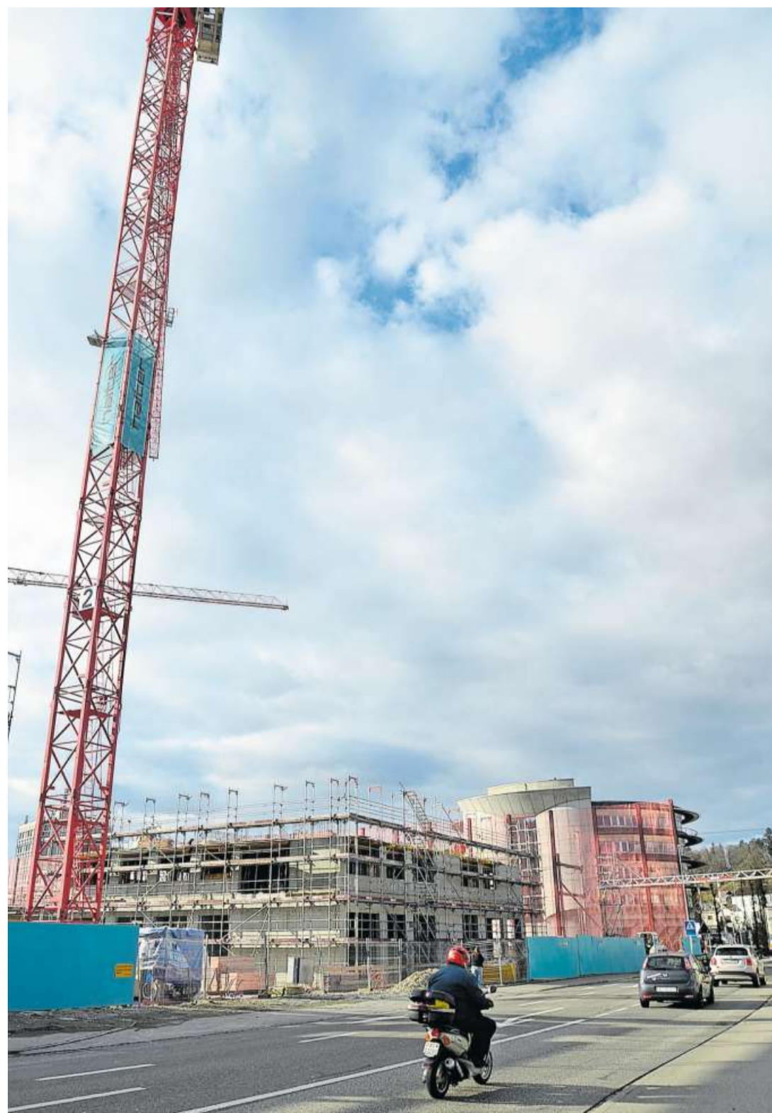
Noch viel Luft nach oben: Zwei von zwölf Etagen des Suhrer Henz-Hochhauses stehen bereits. Bild: dvi
